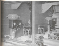
Valvole regolatrici di allentamento (sistemi) sulla turbomacchina «Purina Italia».
